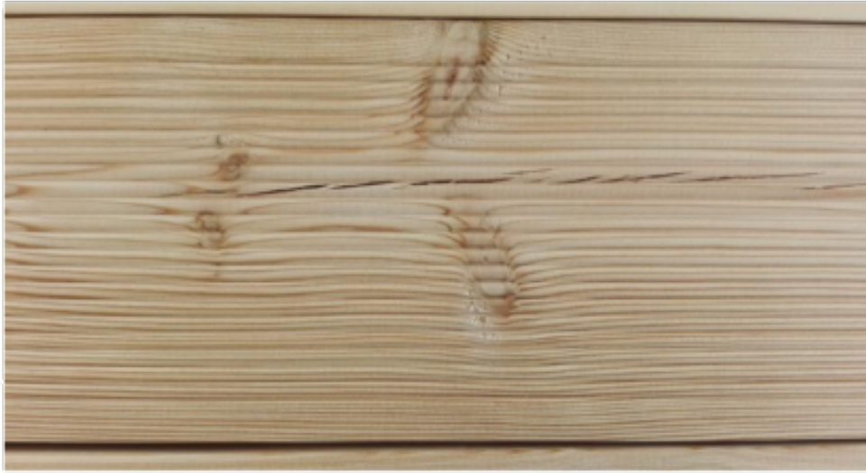
Fot. 3 - pęknięcie włosowate
