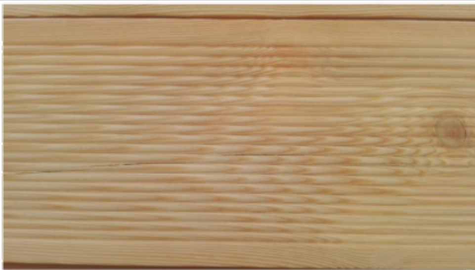
Fot. 16 - pęknięcia typu „włos”
